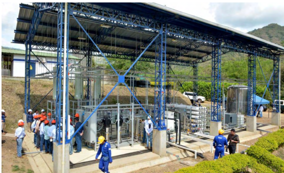
Foto: Planta de tratamiento de lixiviados: Elimina los contaminantes que se producen en los lixiviados generando efluentes más limpios.
