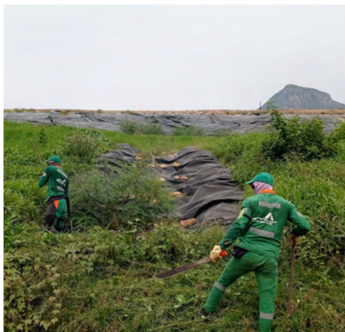
Foto: Control de aguas lluvias: Evita por medio de canales y drenajes que el agua de lluvia ingrese a las celdas del relleno sanitario
